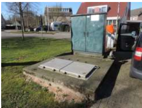
Rioolgemaal aan de Pastinaak te Wijhe
